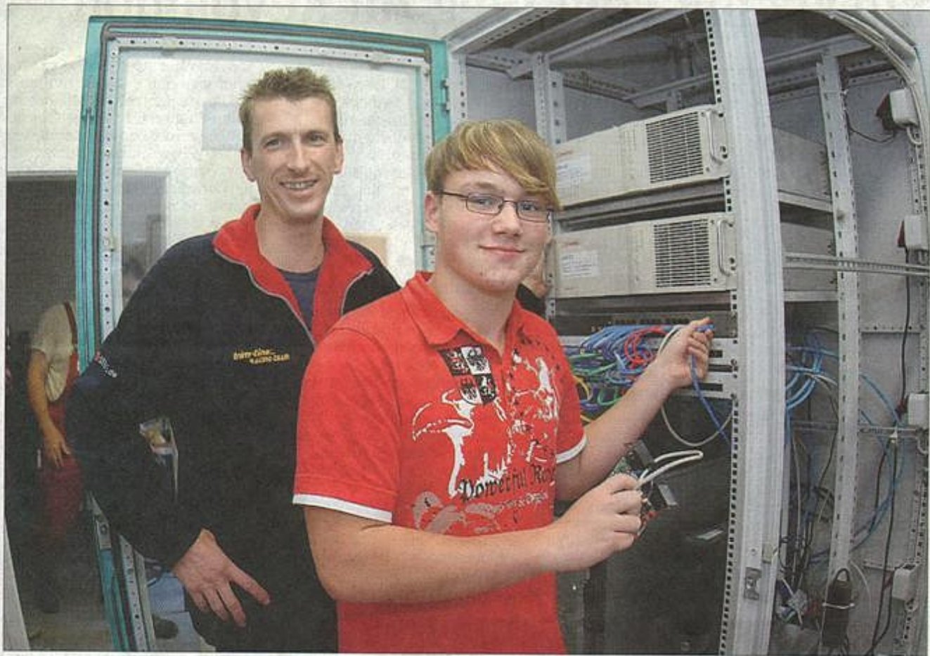
Ausbilder Stefan Döring und Benjamin Seibt arbeiten gemeinsam an einem Serverschrank. Er ist die Datenzentrale eines Unternehmens, vollgestopft mit Elektronik, und muss auch für Laien hinreichend beschriftet werden. Das sei gar nicht immer so einfach, hat Praktikant Benjamin festgestellt. Aller zwei Wochen ist er jetzt einen Tag bei der Süd-Ost Brandschutz e. K. in Großschönau.
